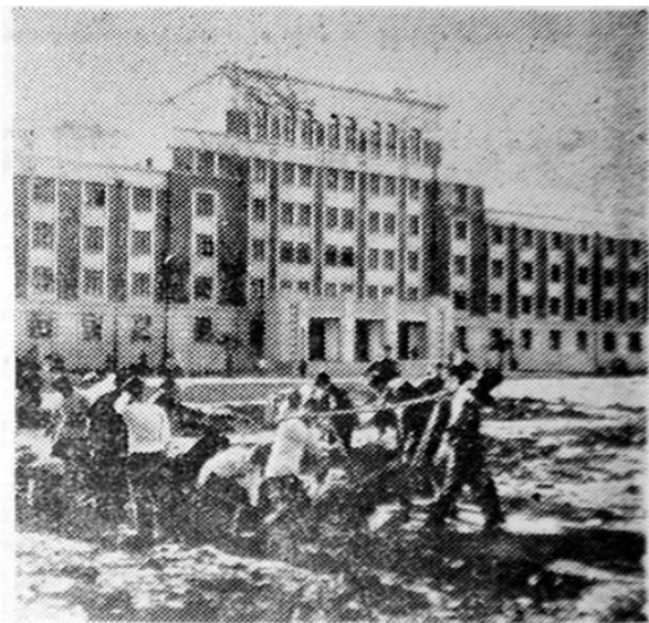
用自己的双手建设亲爱的校园，图为北京工业学院同学们正在修建主楼前的广场。
