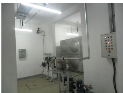
地下水泵隔音室
