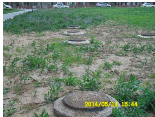
丹枫园 B 楼化粪池
